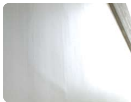
Selv efter en nok så faglig korrekt pletspartling forbliver gipspladesamlinger synlige.
